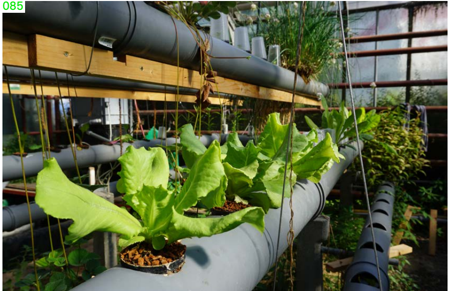
L Stuttgart, Urbane Gärten (→ 31): Bewässerungssystem – Lebensmittelproduktion ist jedoch nur ein nachrangiges Ziel des Projekts
